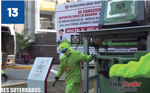
CONTENEDOR SOTERRADO URB. LOS RECAUDADORES
